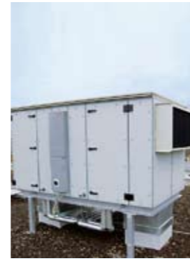
Zehnder ComfoAir 1500 Lüftungsgerät auf dem Dach
