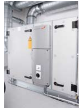
Zehnder ComfoAir 1500 Lüftungsgerät im Keller
